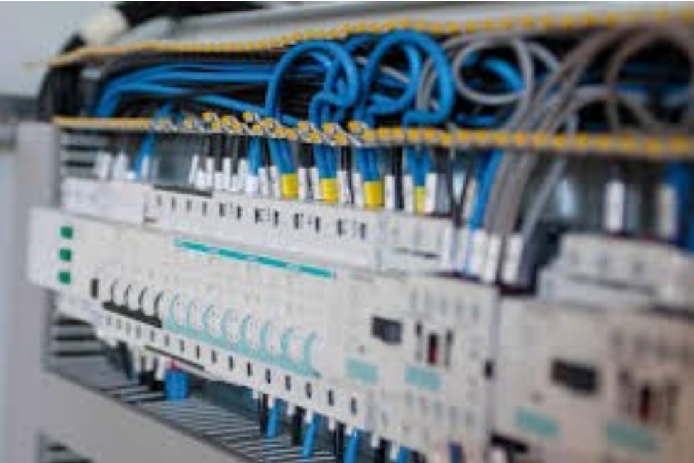
Quadro Elettrico foto web
